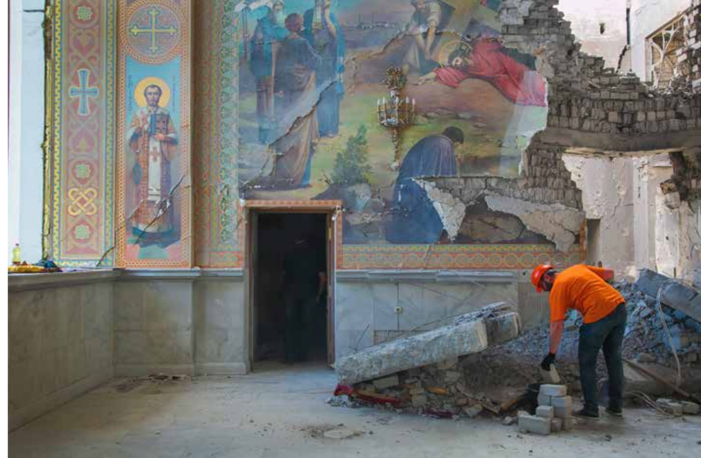
Die Verklärungskathedrale in Odesa wurde am 23. Juli 2023 durch einen russischen Raketenangriff schwer beschädigt (Aufnahme vom 28. Juli 2023).
